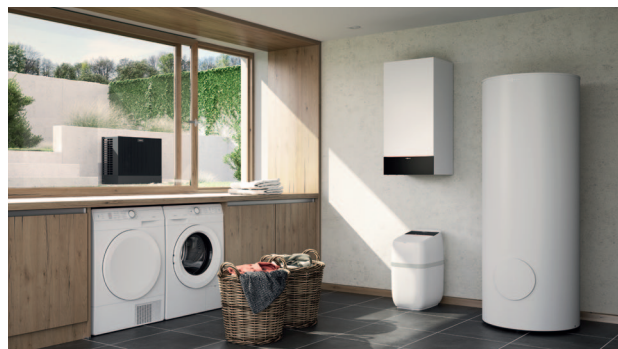
Pompa ciepła powietrze/woda Vitocal 200-S z zainstalowanym pod nią systemem zmiękczenia wody pitnej Vitaset Aqua.
